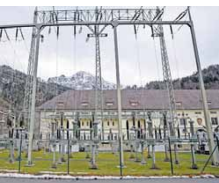
Die Zukunft des Walchenseekraftwerks beschäftigt derzeit viele. FOTO: H. WOLFSBAUER
